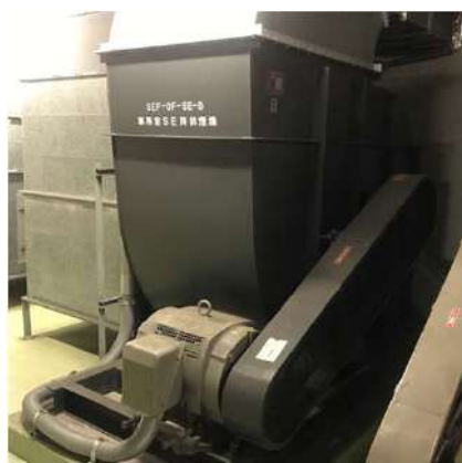
④ 排煙機起動 (自動)
