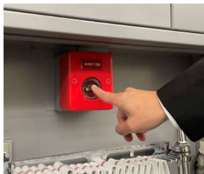
② 消火栓ポンプ起動ボタンを押す
