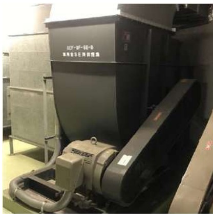
④ 排煙機起動 (自動)
